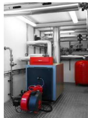
Figure 51 : Chaudière dans un container
