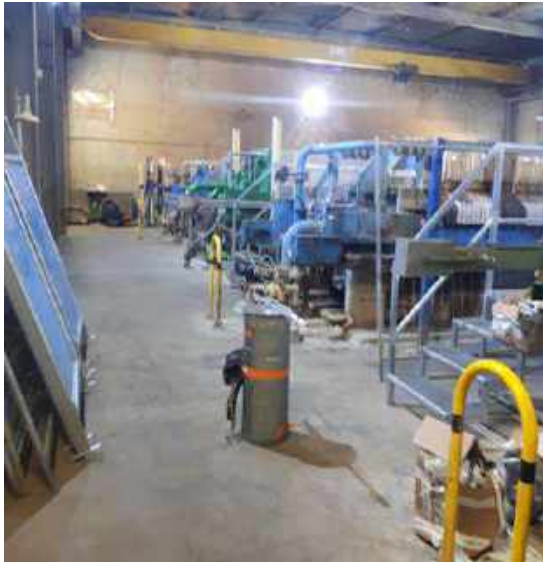
Photo 7 : Local déshydratation des boues
