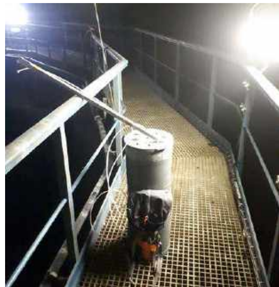
Photo 4 : Bassin tampon A et B
