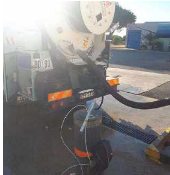
Photo 8 : Dépotage matières externes
