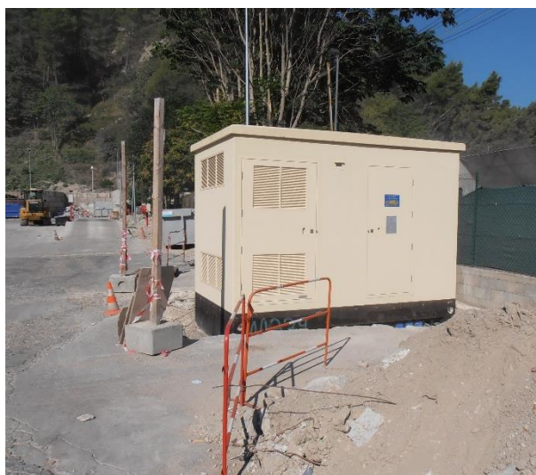
Figure 6 : Local de transformation
