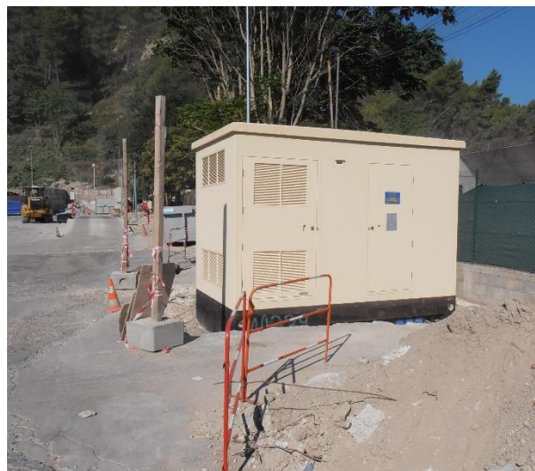
Figure 3 : Local de transformation
